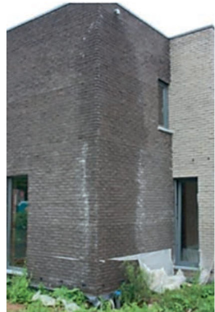
Fig. 6: Ontbreken van voorlopige waterafvoer dak
