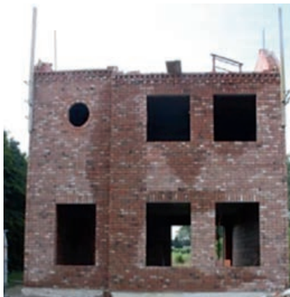
Fig. 5: exemple de situation à éviter
